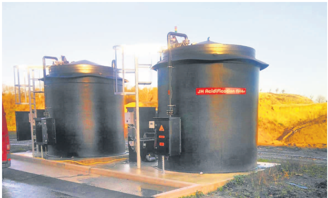
Die Anlage von Heinz-Hermann Hemme kann Gülle wahlweise mit Schwefel- oder Essigsäure ansäuern. Beide Tanks fassen jeweils 25 Tonnen Säure. Für die Erstbeimischung im Güllekeller waren allein 17 Tonnen Schwefelsäure nötig, die den pH-Wert der Gülle von 8 auf 5,6 absenkten.
